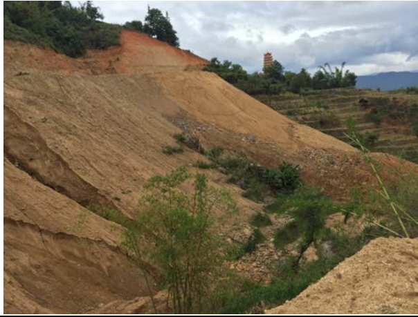
2015年8月 道路边坡情况
